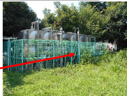
多摩川小受水槽
